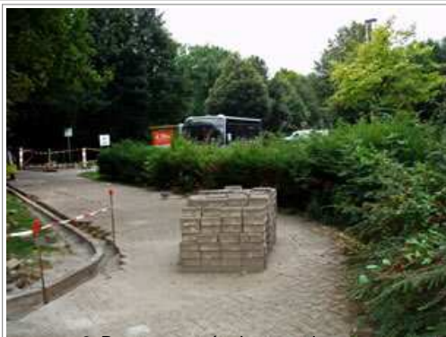
2. Passage trop étroit pour voiturettes
